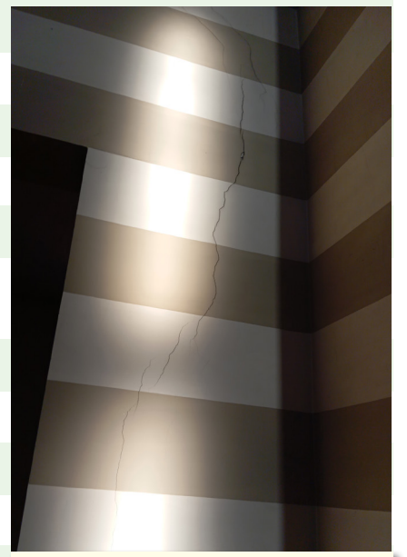
La crepa sul muro in presbiterio
